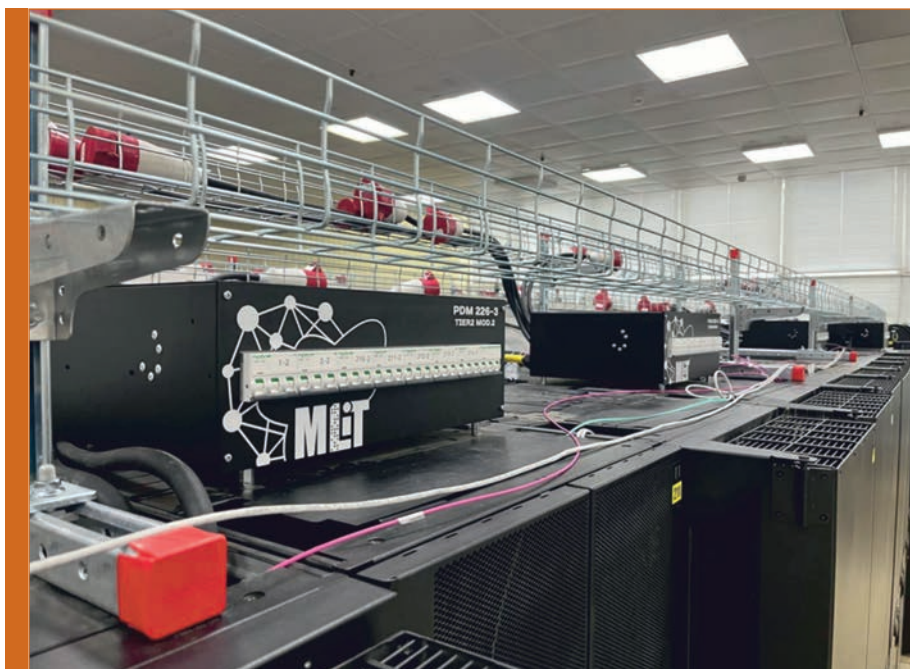
Модули распределения питания (PDM), разработанные в ЛИТ и установленные в МИВК
