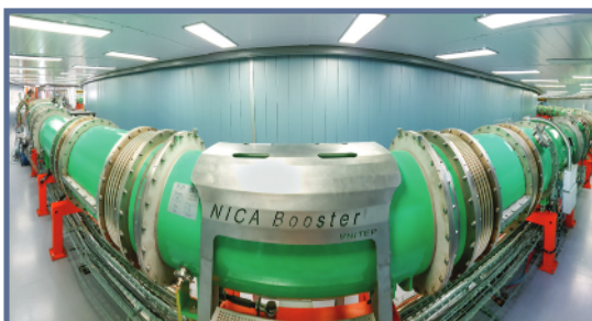
Ввод в эксплуатацию бустера
